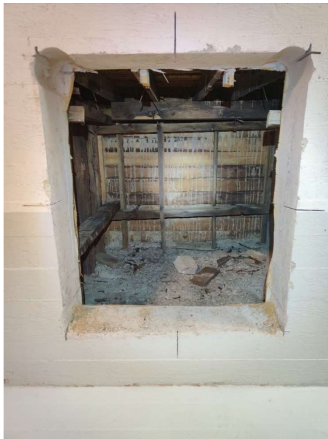
Kuva 9. Hissikuilun seinään tehty työaukko sekä vanha laudoitus ja rakennusjäte.
